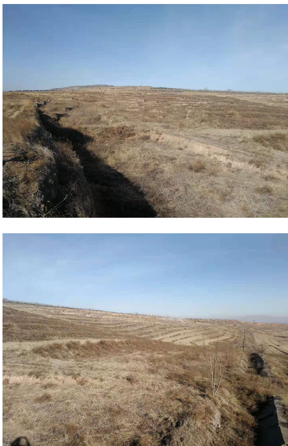
照片 4-1 现状存在的塌陷坑和地裂缝
