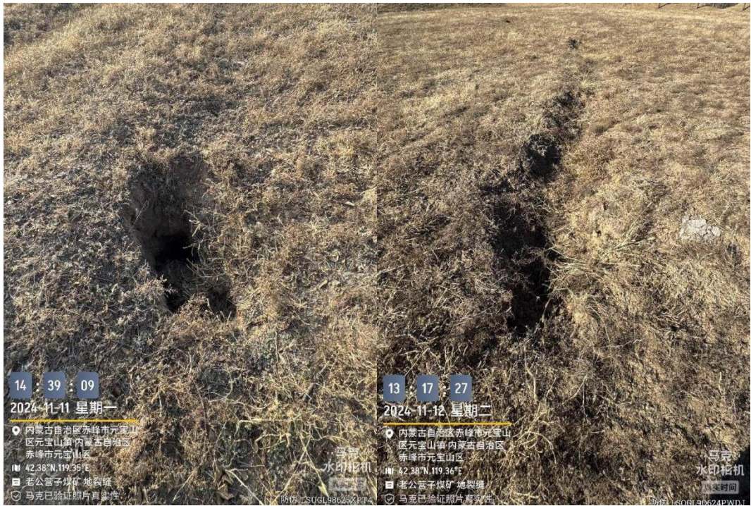
图 3.2-2 现状存在的地裂缝
